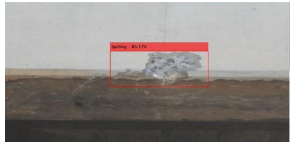
รูปที่ 4.5 ตัวอย่างผลลัพธ์การตรวจจับ Spalling
