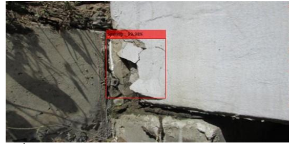
รูปที่ 4.3 ตัวอย่างผลลัพธ์การตรวจจับ Spalling
