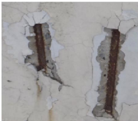
รูปที่ 2.3 เหล็กเสริมในคอนกรีตโผล่ออกมาให้เห็น (Steel Exposure)
