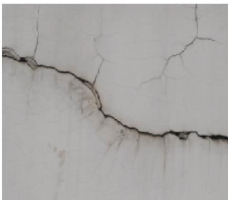
รูปที่ 2.2 รอยแตก (Cracking)
