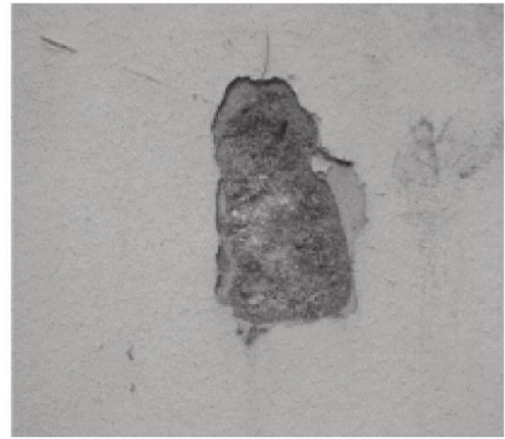
รูปที่ 2.4 การหลุดล่อน (Spalling)
