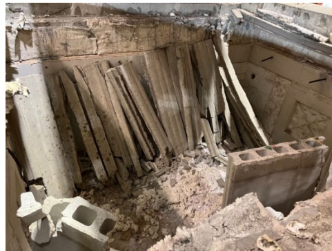
รูปที่ 3-1 ภาพถ่ายของชั้นตัวอย่างทดสอบภายหลังการวิบัติเชิงโครงสร้าง
