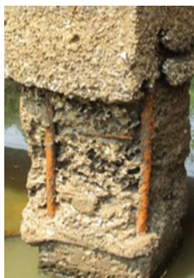
รูปที่ 2.9 ตัวอย่างความเสียหายชนิด Steel Exposure
