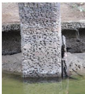
รูปที่ 2.6 ตัวอย่างความเสียหายชนิด Erosion
