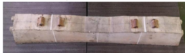
รูปที่ 7 หมอนรองคอนกรีตสภาพมีรอยแตกกว้าง
