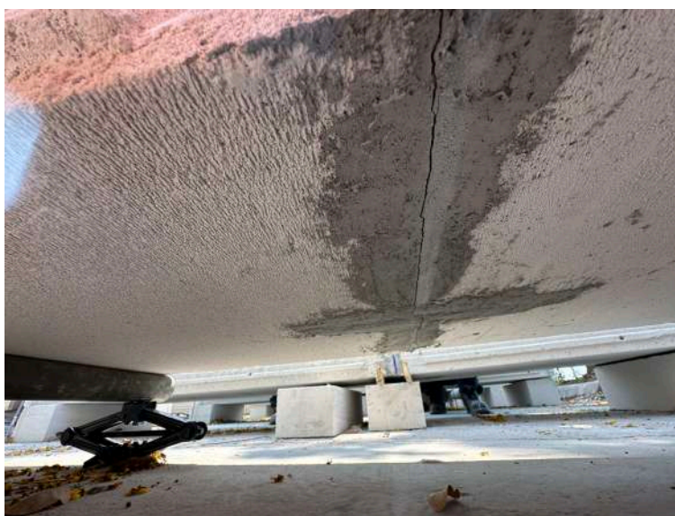
รูปที่ 3.4 ภาพการเกิดรอยแตกในแผ่นคอนกรีตมวลเบาที่ First Crack
