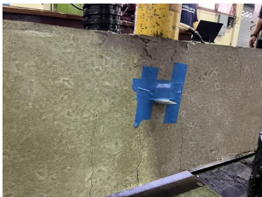
รูปที่ 9 รอยแตกร้าบริเวณท้องคานที่เกิดจากการวิบัติแบบโมเมนต์ดัด
