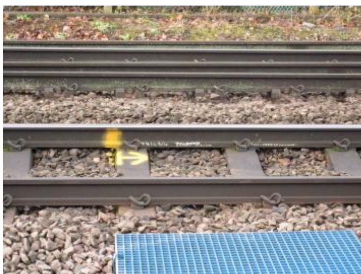
รูปที่ 2.4 Continuously Welded Rail
