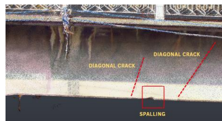
รูปที่ 3ข. รอย crack ที่เกิดบนคานหลักสะพานสำรวจด้วยกล้อง 3D-SCAN
